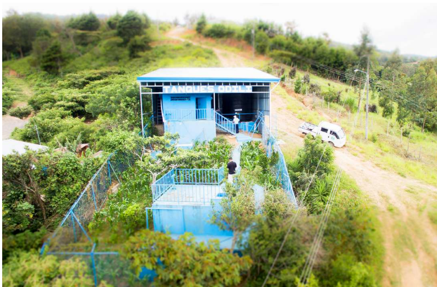
Figura 16. Tanques de almacenamiento, ASADA de Tobosí de Cartago. Fuente: CEDARENA, 2022.
